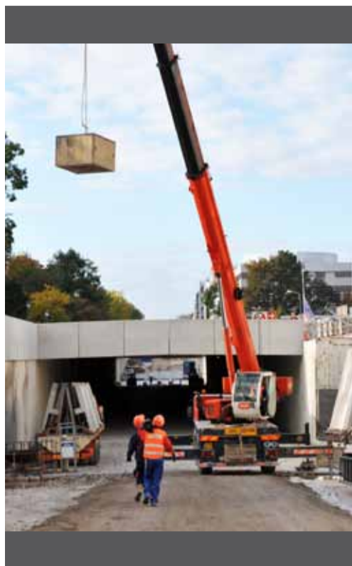
Construction de la trémie routière devant la gare SNCF centre de décembre 2009 à juin 2010.
